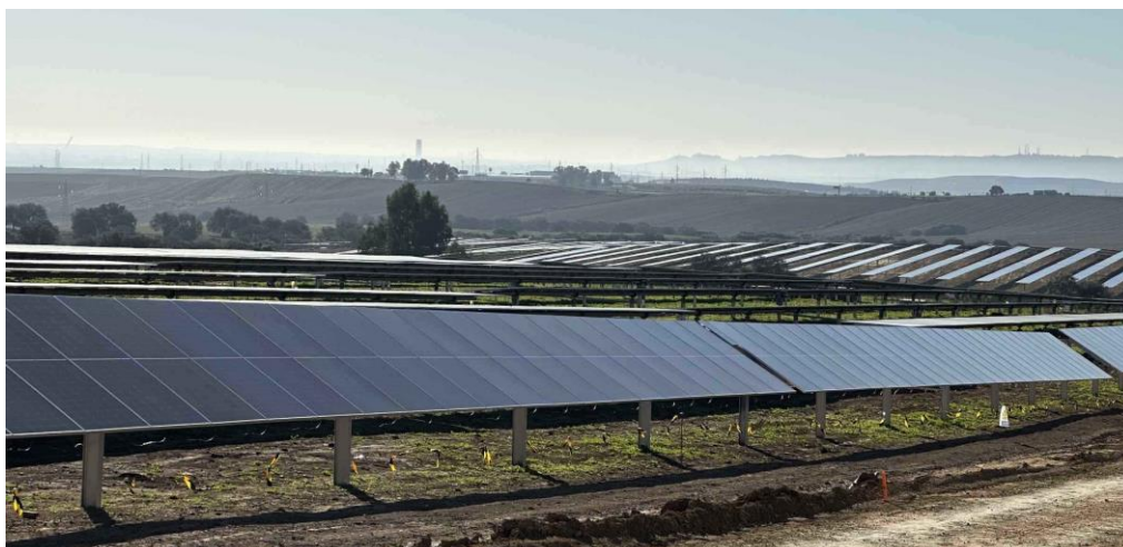
Figura 1: Planta solar Esparragal I construida por Endesa de 47,5 MW. [1]
