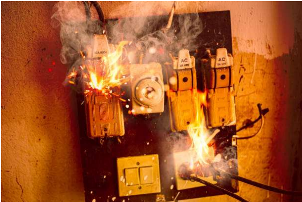
Ilustración 26: Riesgo de incendio por fallo eléctrico.
