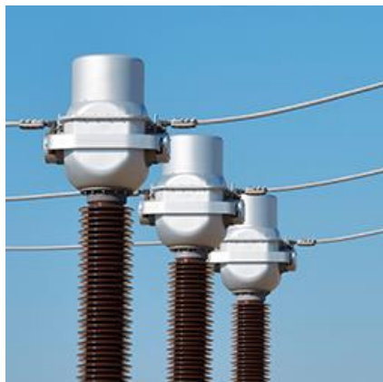
Ilustración 42. Bobinas de bloqueo en una subestación.
