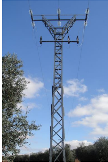
Ilustración 46. Apoyo metálico típico de una línea aérea de alta tensión.
