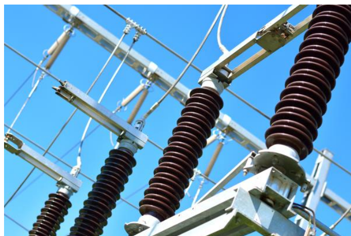
Ilustración 40. Autoválvulas instaladas en una subestación.
