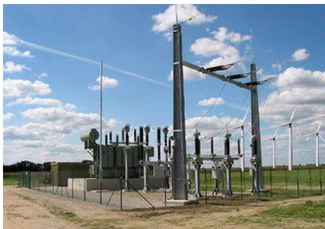
Ilustración 31. Ejemplo de subestación AIS.
