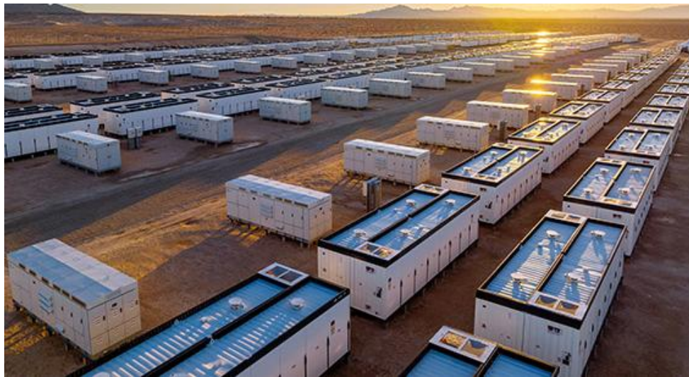
Figura 13. Proyecto BESS Crimson Energy Storage [Energy Storage.news]
