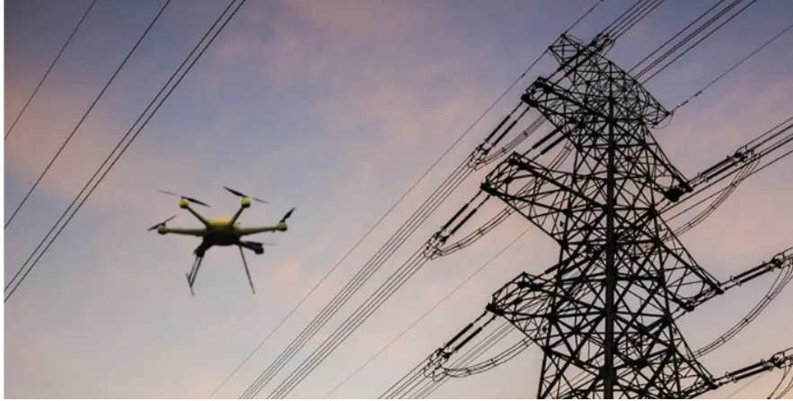
Figura 2.3: Aplicación de drones para inspeccionar líneas eléctricas de alta tensión (Fuente: Telefónica Tech)
