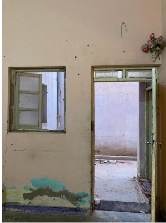
Imagen 4. Humedad en habitación interior de vivienda. Fuente de elaboración propia.
