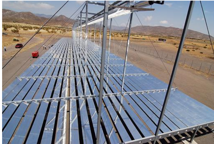
Figura 9. Colector de demostración Fresnel lineal MAN instalado en la Plataforma Solar de Almería [11]
