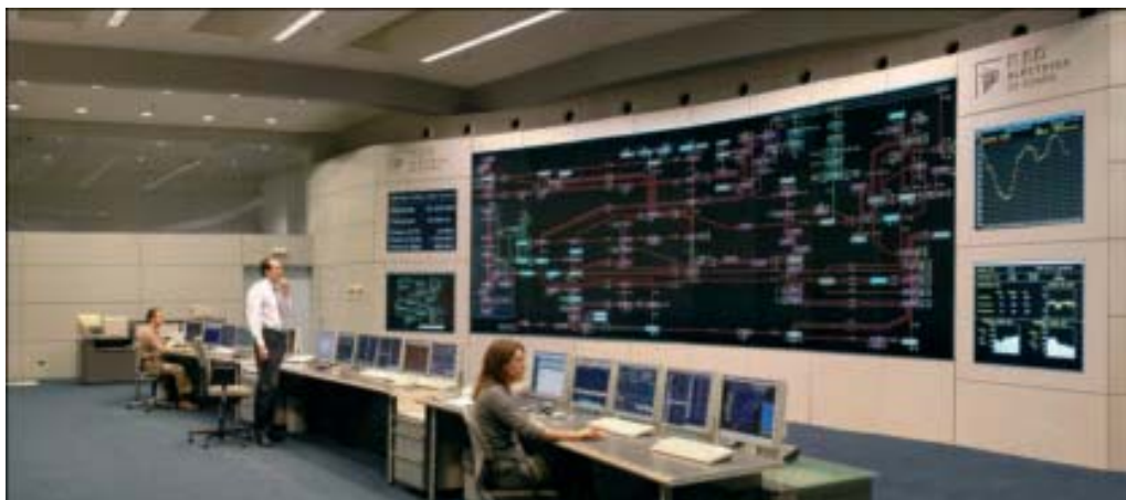
© Red Eléctrica de España (Spain)
