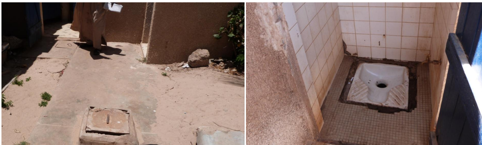
Fotos 14 y 15. Área de Baños y saneamiento del Centro
