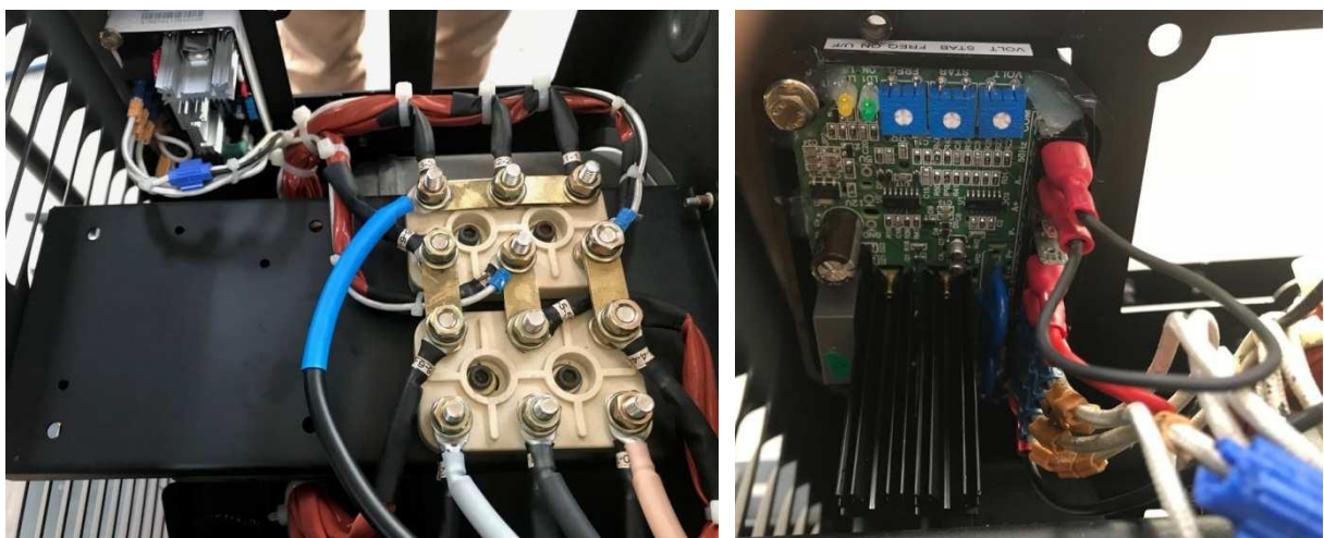
Figura 25. Instalación de las AVR DBT 63-4 (izqda.) y AVR5 (dcha.)
