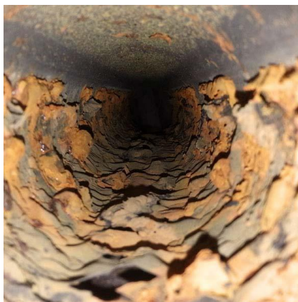
ILUSTRACIÓN 11 TUBERÍA CORROÍDA. FUENTE: ESPANOL.LUBRIZOL.COM
