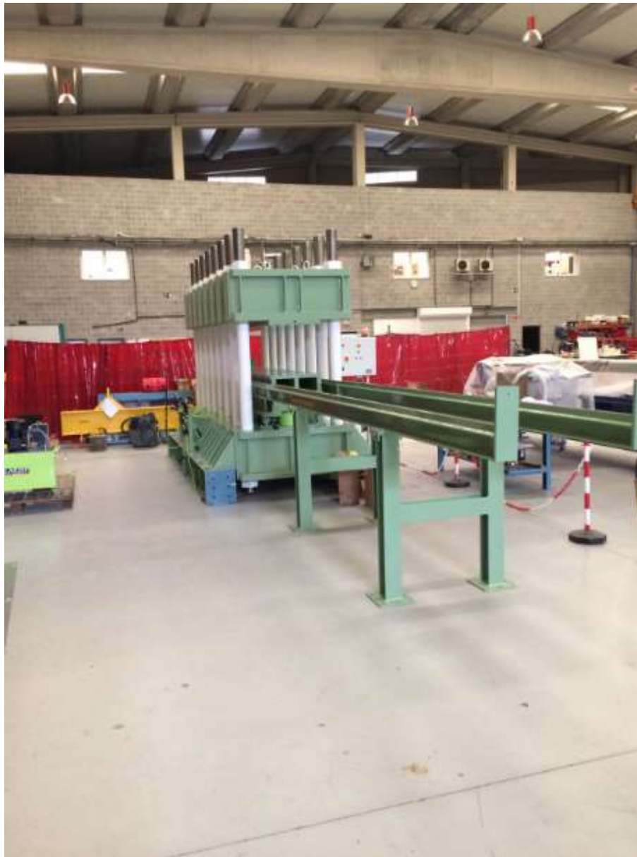
Imagen 7, Vista de la prensa de polimerización y el sistema de transporte.
