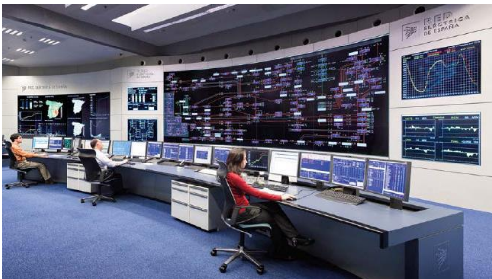
Figura 4. Centro de Control Eléctrico de Red Eléctrica de España 0[12]
