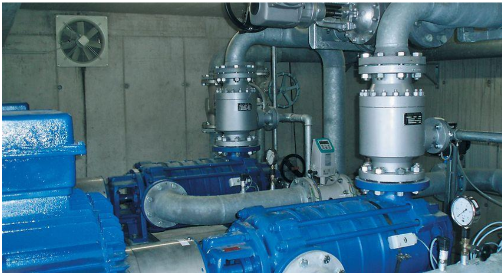
Figura 70. Bombas de alta presión Andritz MP. (Fuente: Andritz)
