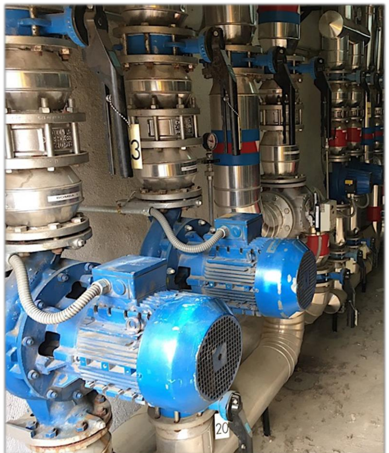
Fotografía 1. Algunas de las bombas en la sala de calderas.
