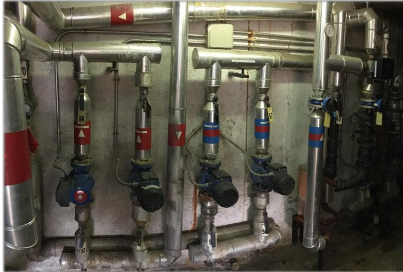
Fotografía 5. Bombas del circuito de ACS. Fuente: propia.
