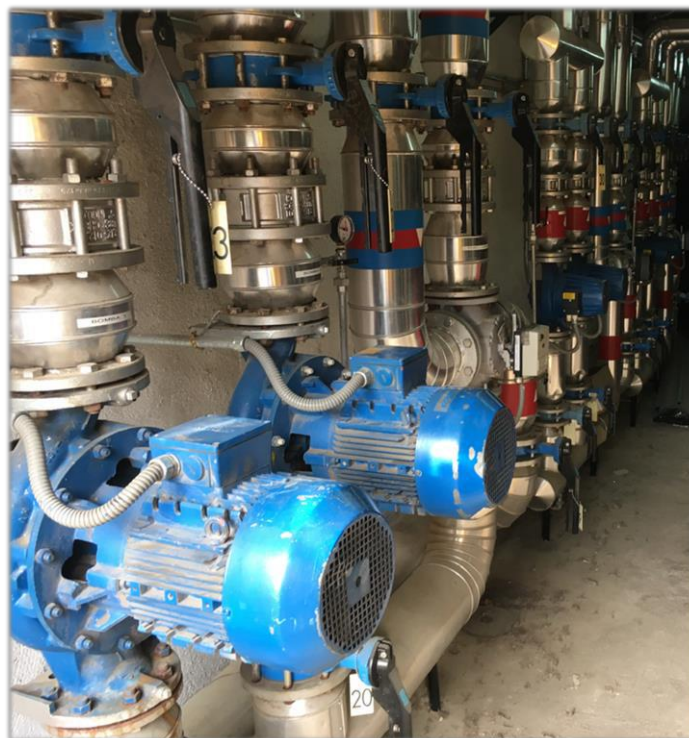
Fotografía 4. Bombas del circuito de calefacción. Fuente: propia.
