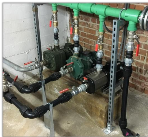
Fotografía 3. Grupo de presión de la sala de bombeo. Fuente: propia.
