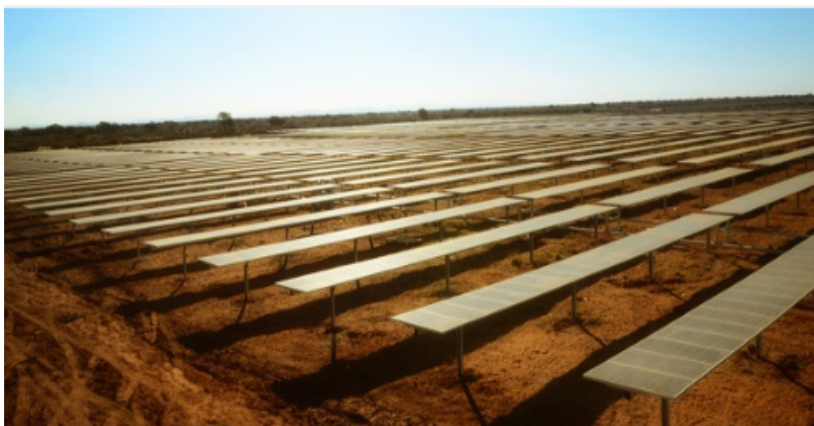
Fotografía n° 7. Instalación solar fotovoltaica promovida por Acciona en África. Fuente: Acciona Energía
