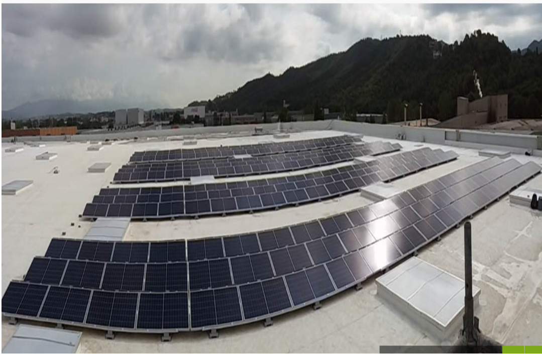
Fotografía nº 6. Aplicación de la solar fotovoltaica para autoconsumo. Fuente: Innover
