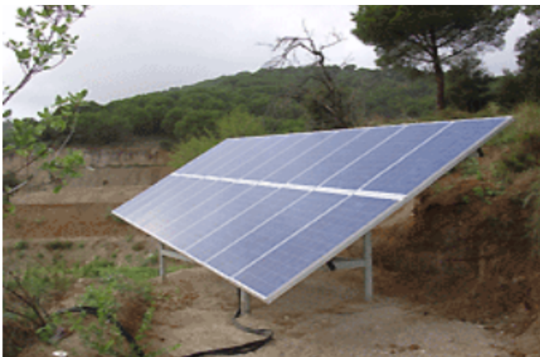
Fotografía nº 5. Aplicación de la solar fotovoltaica para suministro de electricidad a una zona aislada. Fuente: Soliclíma
