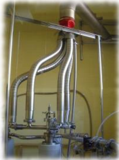
Ilustración 32: Instalación de tuberías de refrigeración en un equipo de resonancia magnética [54]
