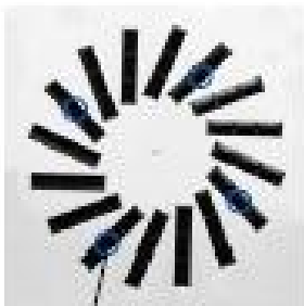
En el medio del deflector se efectúan de 4-6 puntos de medición por difusor dependiendo del tamaño.
