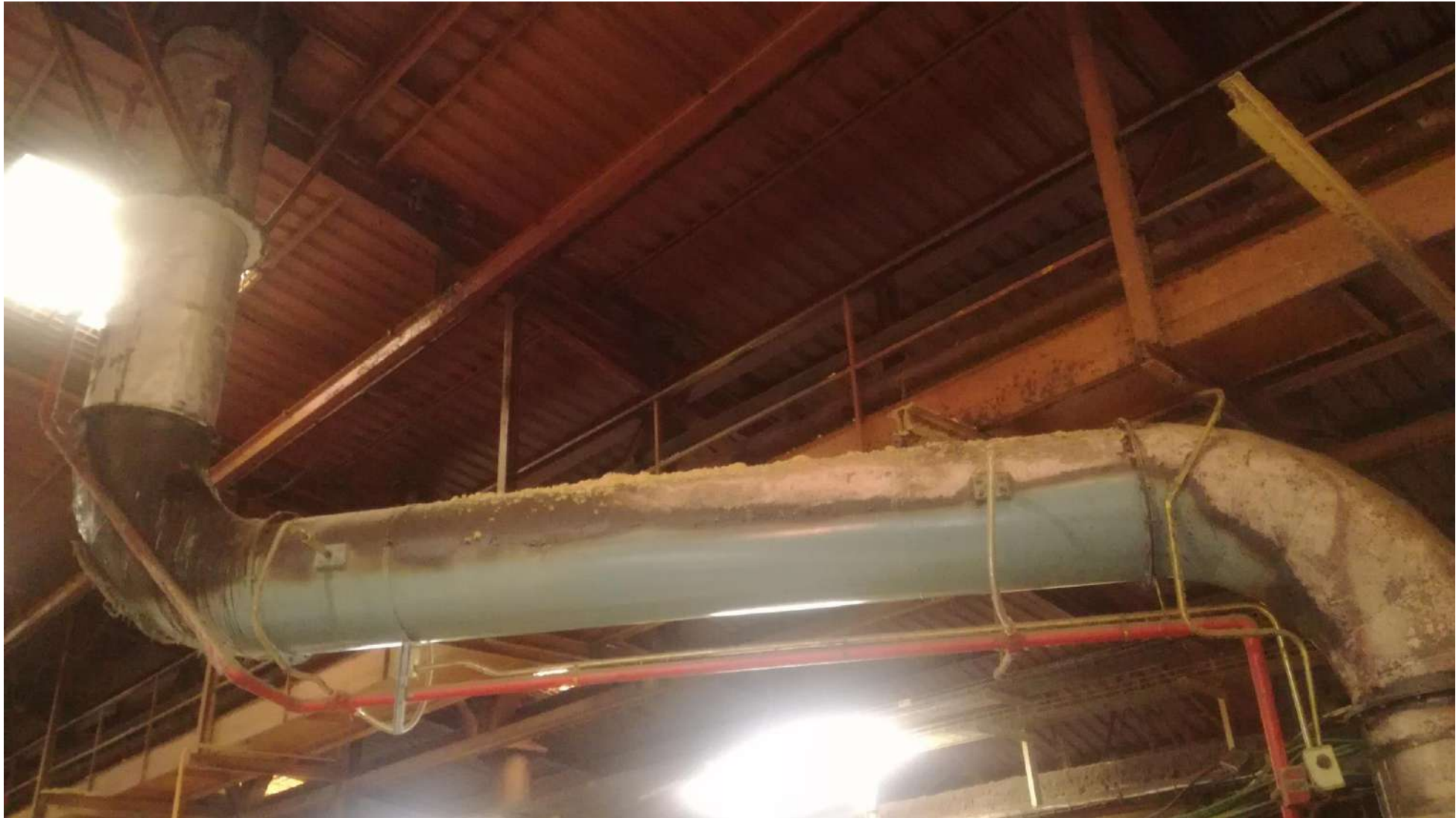
Conducto del lavado de humos de la sección de entrada.
