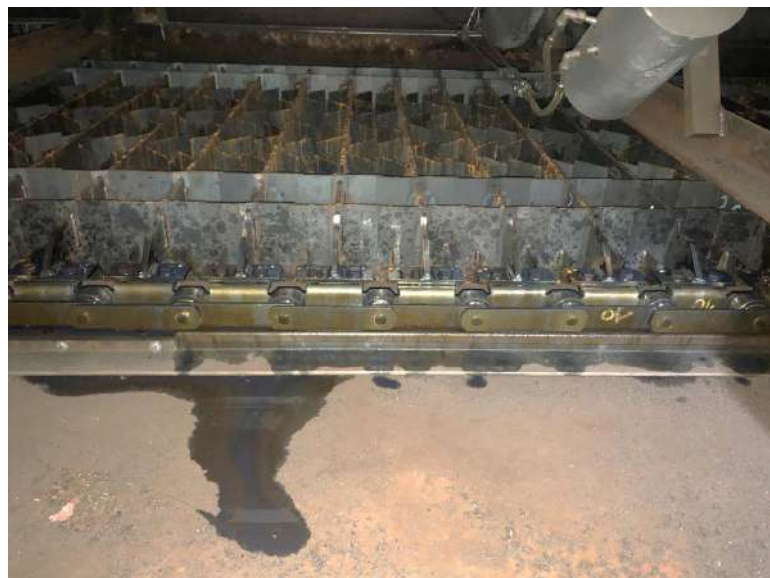
Figura 39: Aceite acumulado en el suelo del interior de la estufa.
