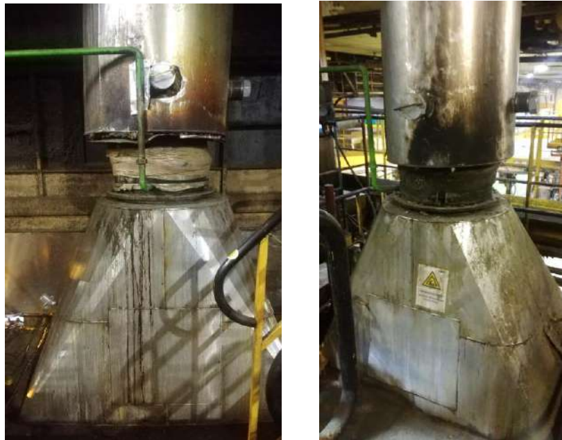
Figura 116: Agujeros en el conducto de la entrada (izquierda) y en el conducto de la salida (derecha).
