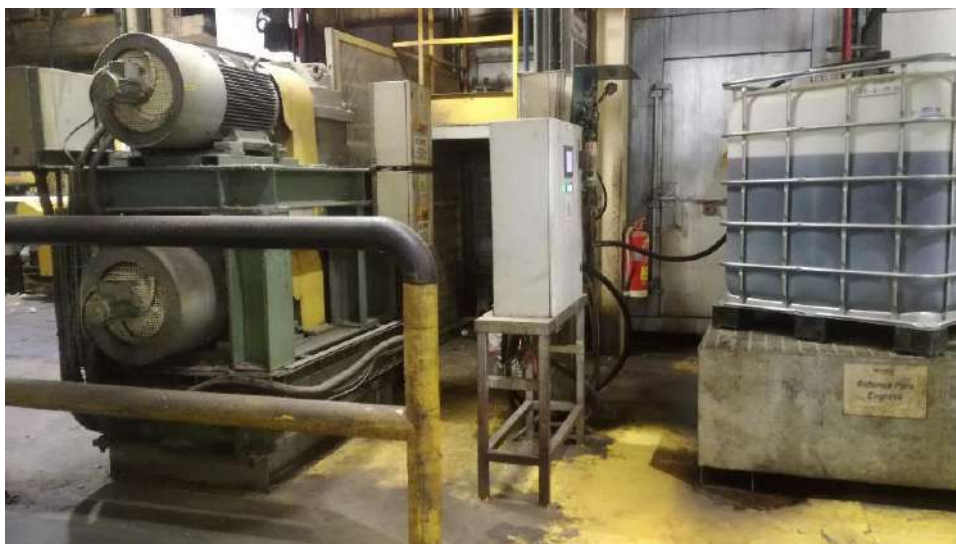
Figura 36: Vista frontal de las unidades motorreductoras que accionan los transportadores.
