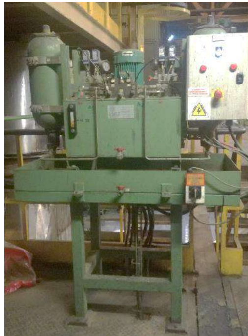
Figura 41: Grupo hidráulico que actúa sobre los sistemas de tensado de las cadenas.
