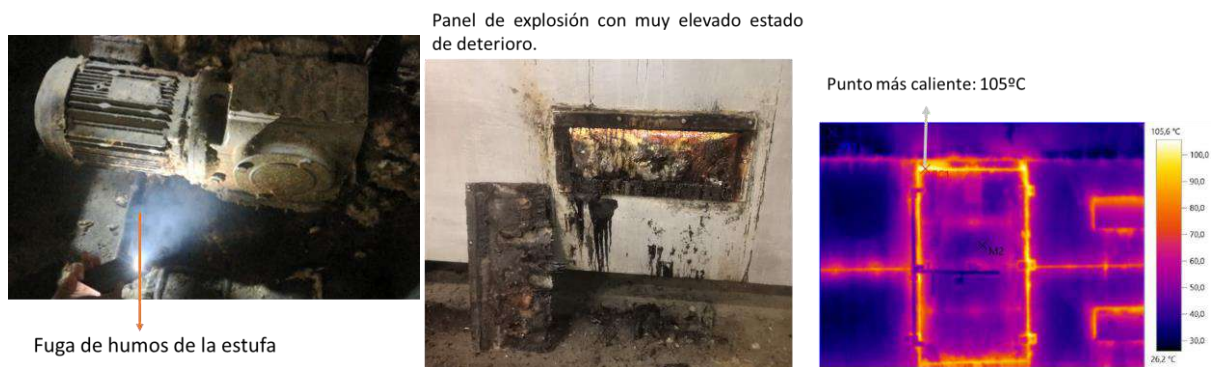
Figura 6: Elementos con fugas, deteriorados y con temperaturas por encima de su rango admisible.
