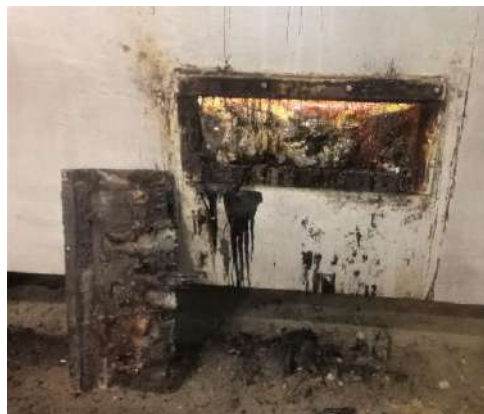
Figura 89: Panel de explosión en avanzado estado de deterioro debido a las fugas por la falta de sellado.
