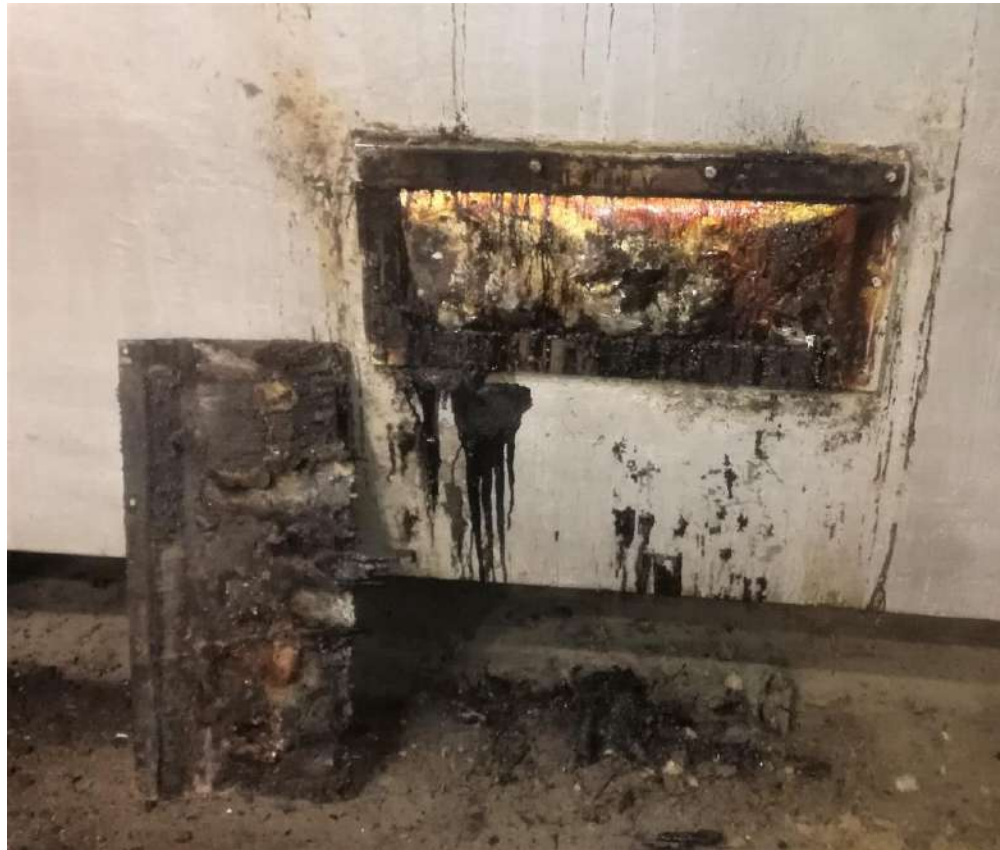
Panel de explosión con muy elevado estado de deterioro.
