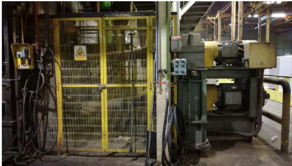
Figura 35: Vista lateral de las unidades motorreductoras que accionan los transportadores.
