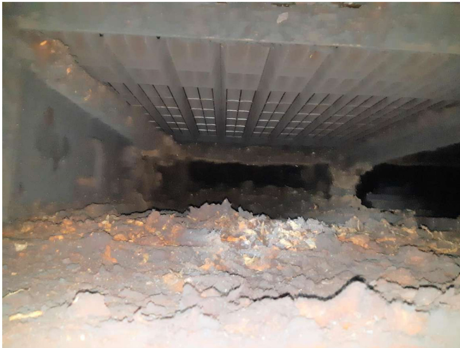
Acumulaciones de lana en el interior del segundo cajón.
