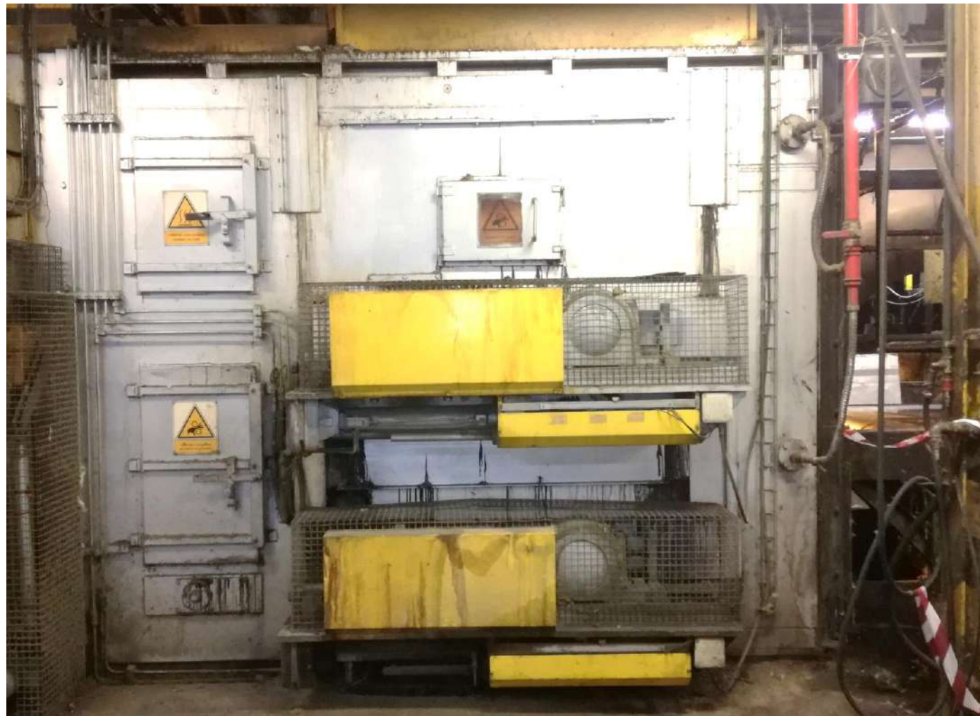
Sistema de tensado de las cadenas del transportador superior.
