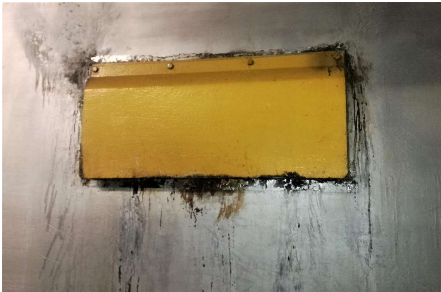
Panel de explosión con bajo estado de deterioro.
