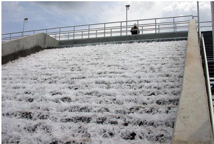
Figura 29: Aireadores de cascada (Fuente: (Sebastián, 2017))
