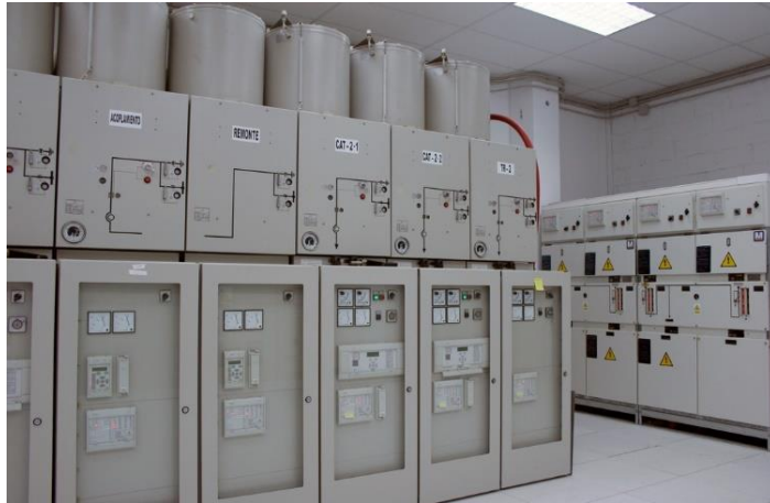
Fig. 10: Subestación tipo interior
