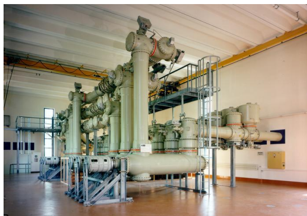
Fig. 11: Subestación tipo blindado
