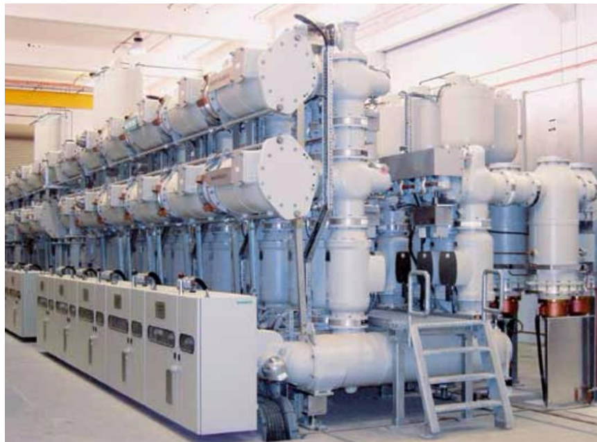
Fig. 15: Celdas modelo 8DN9 del fabricante Siemens
