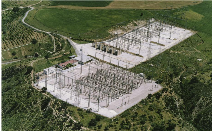
Fig. 9: Subestación tipo intemperie
