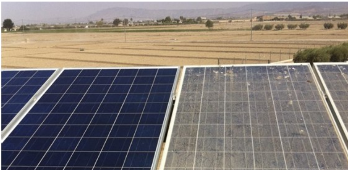
Ilustración 30 Paneles limpios vs Paneles sucios. Fuente: Generatuluz
