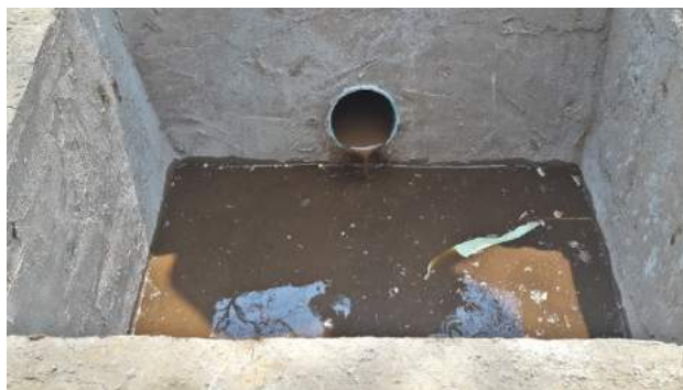
Ilustración 33. Tubería en el silo de salida. Fuente: El autor.
