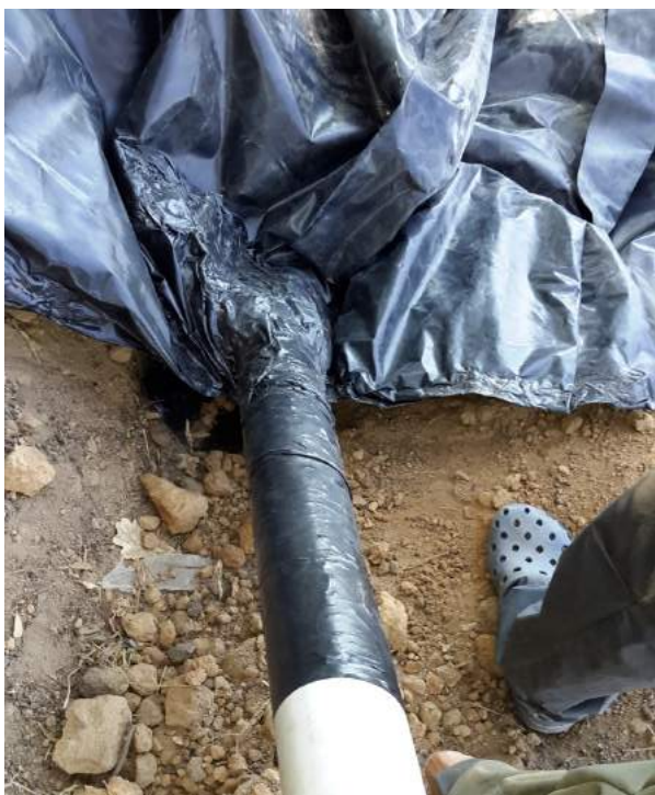
Ilustración 50. Unión de la tubería de salida.
