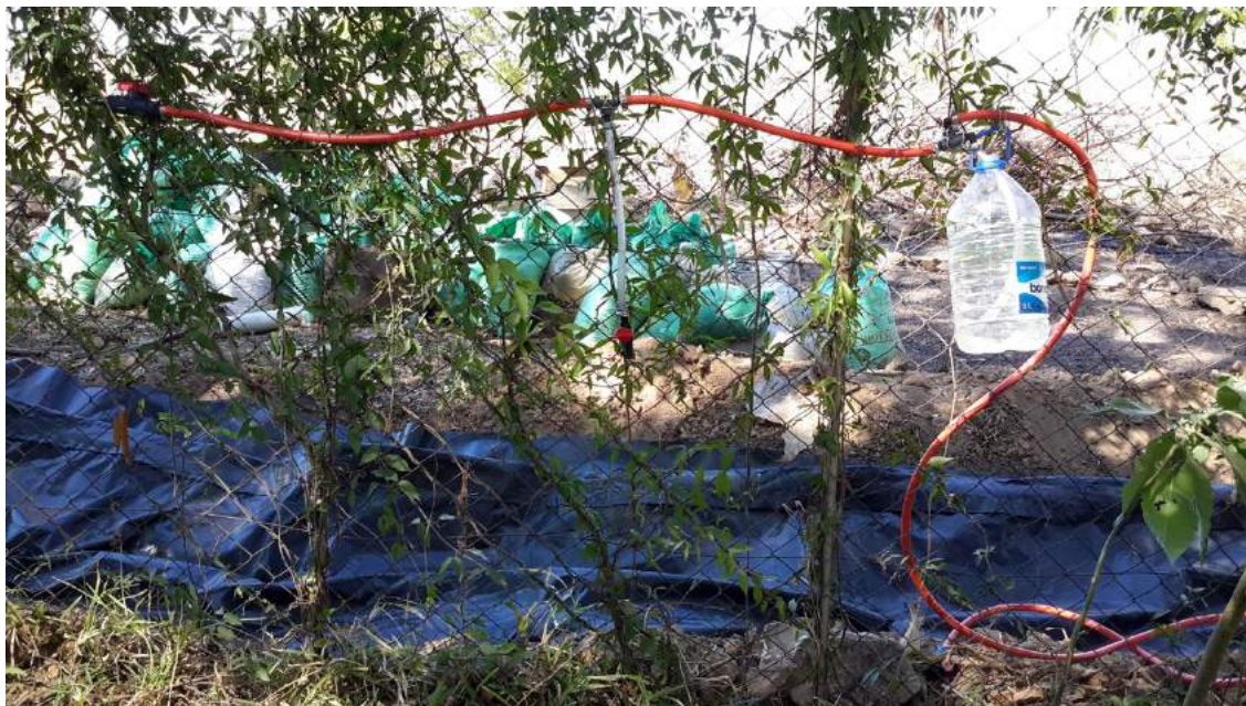
Ilustración 55. Tubería para el gas con sistema de purga, válvula de seguridad y final ampliable para la conexión de una tubería mayor.
