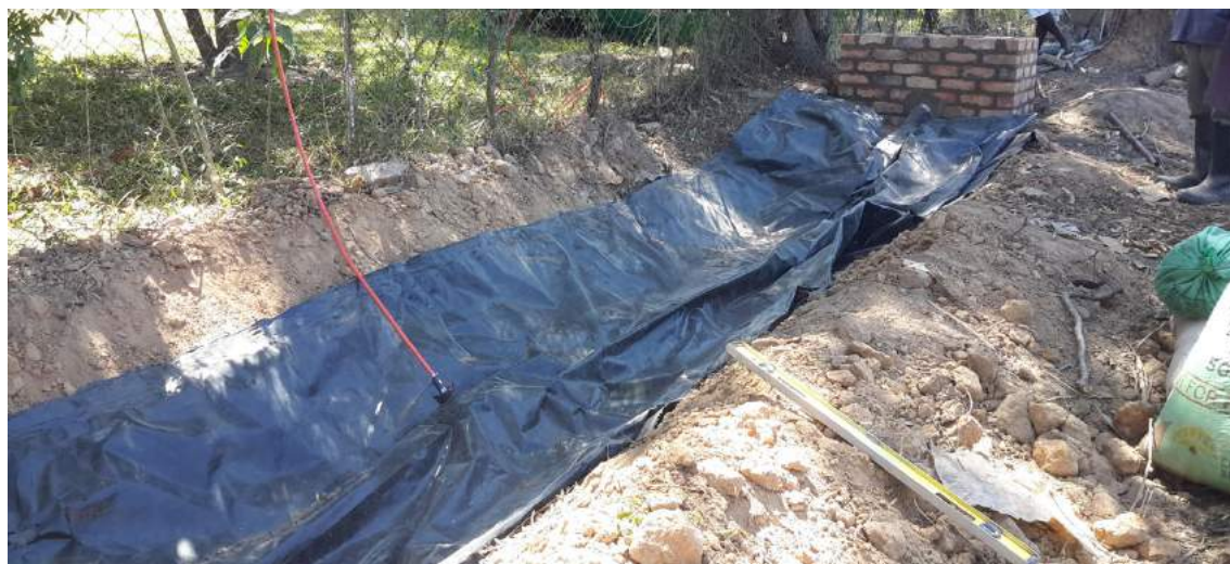
Ilustración 52. Biodigestor instalado antes de ser llenado.
