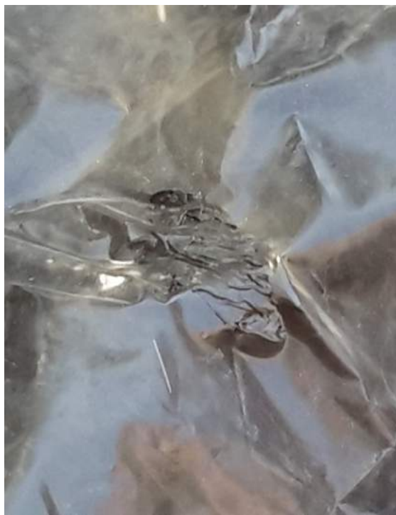
Ilustración 51. Parche sobre la fuga.
