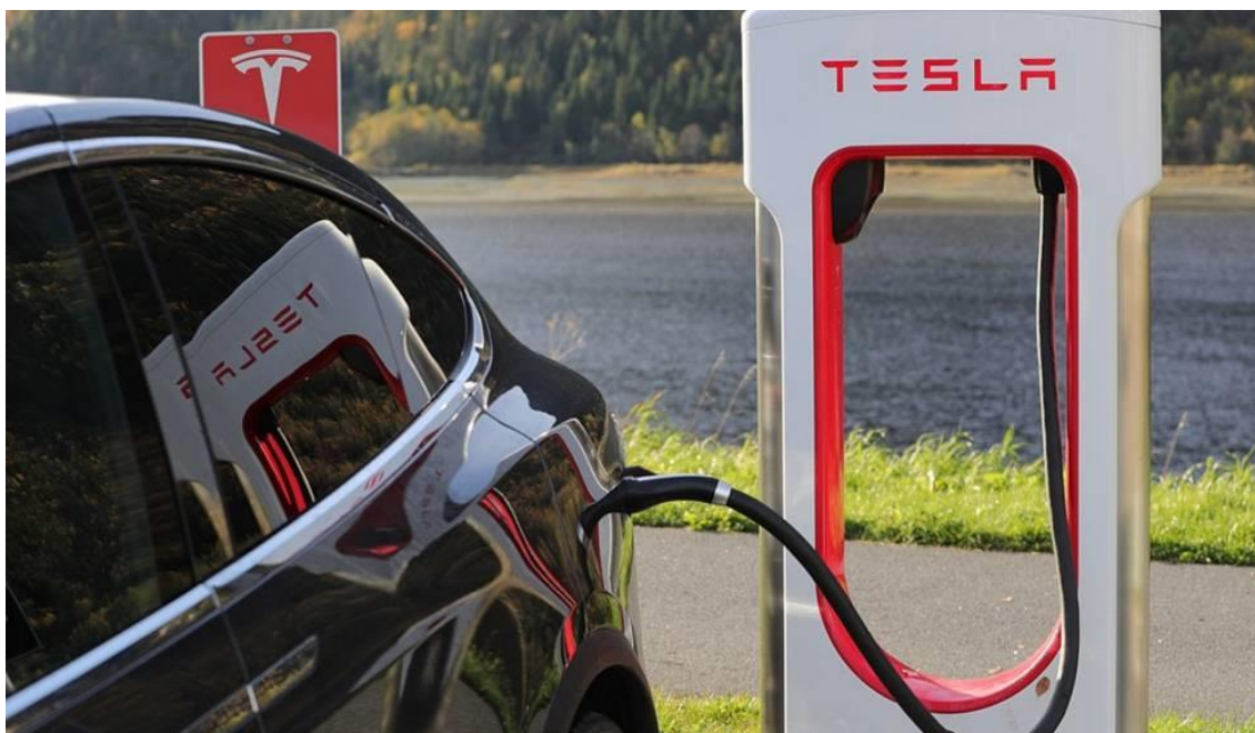
Figura 42: Punto de carga igual al que se pondrá en la instalación. Pr.Tesla web
