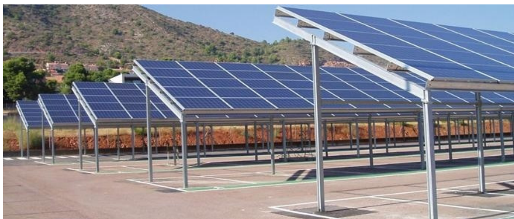
Figura 11. Estructura de soporte fija para paneles solares fotovoltaicos. (Fuente: [47])
