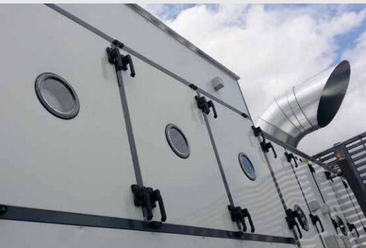
Unidades TKM 50 HE de TROX suministradas en los Laboratorios Pharma Mar (Madrid).
