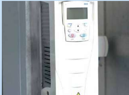
Convertidor de frecuencia Para proporcionar a la instalación el caudal de aire requerido en cada momento. Permite un ahorro energético mayor, al adaptar el consumo de los motores a las necesidades reales de la instalación.
