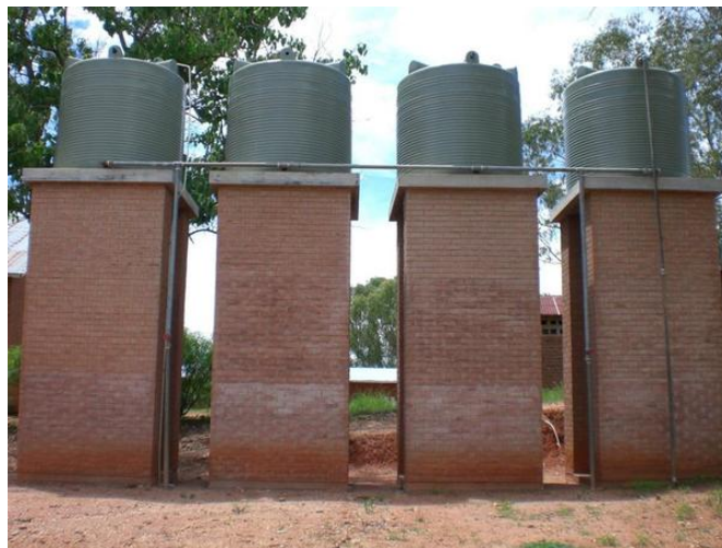
Ilustración 9 Instalación en hospital atupele. Fuente: Auara
