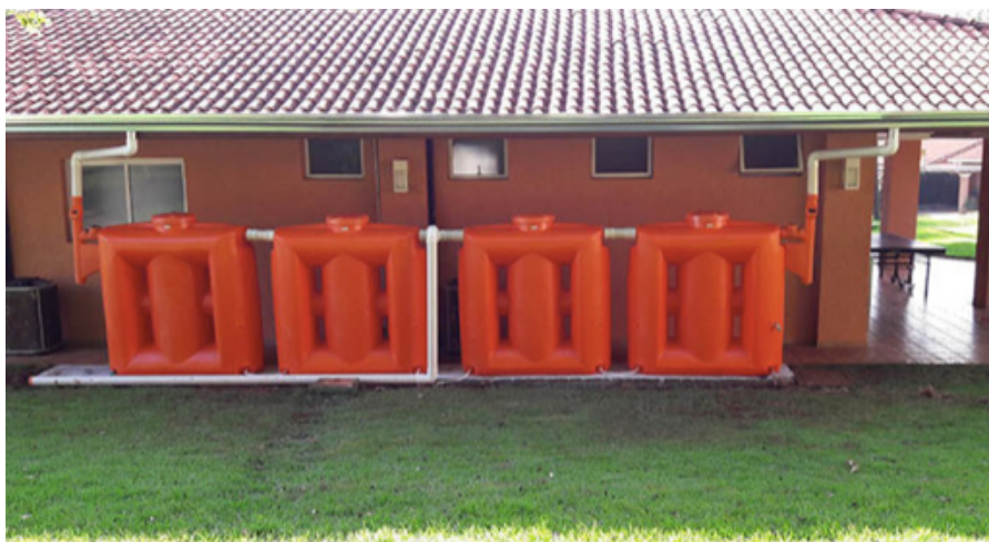
Ilustración 13 Sistema de captación del agua de la lluvia. Fuente: https://www.arrevol.com/blog/5-sistemas-metodos-para-reaprovechar-reutilizar-el-agua-de-lluvia
