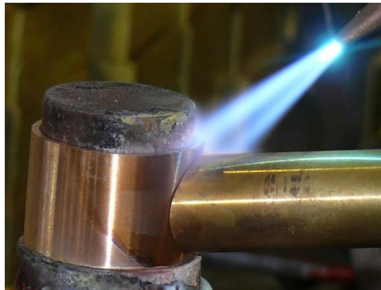
Imagen 92: Ejemplo de Soldadura Amarilla
