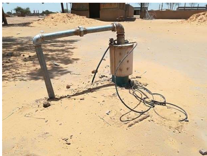
Ilustración 4. Pozo con bomba eléctrica fuera de servicio
