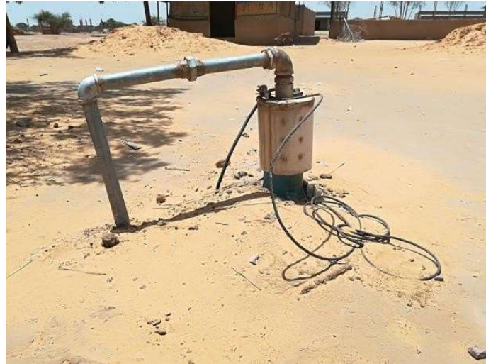
Ilustración 4. Pozo con bomba eléctrica fuera de servicio
