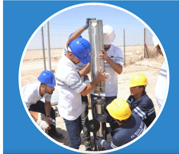
Ilustración 37: Instalación de una bomba sumergible helicoidal Lorentz
