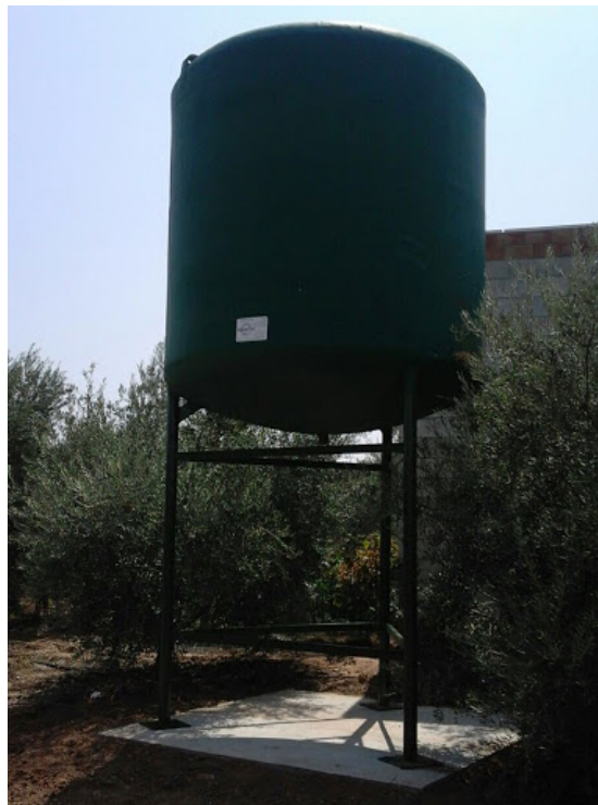
Ilustración 33: Depósito vertical con patas metálicas
