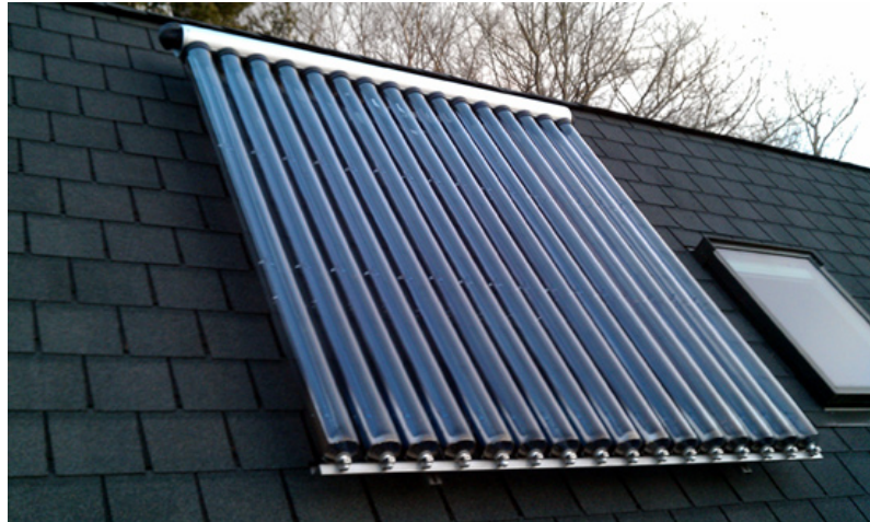
Figura 19 - Colector solar de tubos vacíos.
