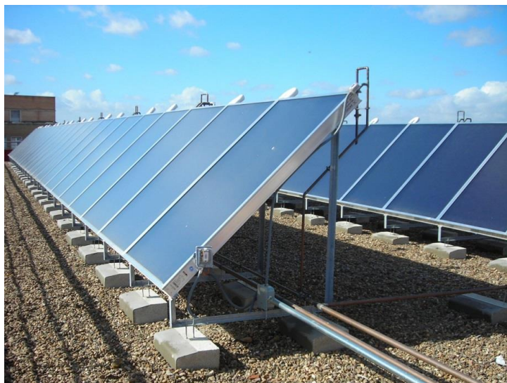
Figura 13: Estructura soporte de paneles fotovoltaicos
