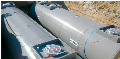
Fig. 16: Tanques Lapesa instalación enterrada. Obtenida la página de Lapesa
