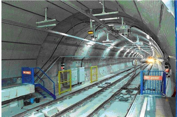
Ilustración 2 Catenaria Rígida (Metro MAdrid) (fotografía: http://ferropedia.es/mediawiki/index.php/Archivo:Julian_Besteiro.JPG )
