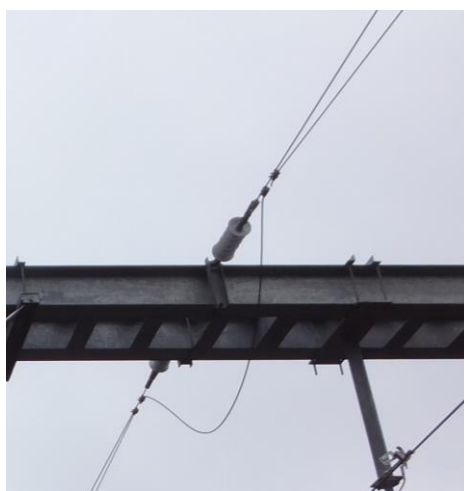
Ilustración 18 Mid Point Anchor en dintel del perfil 13-14D
