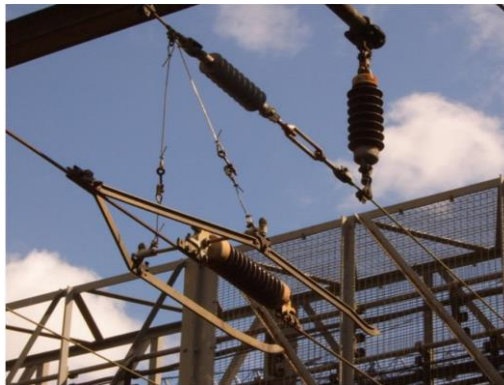
Ilustración 16 Aislador de sección pesado
