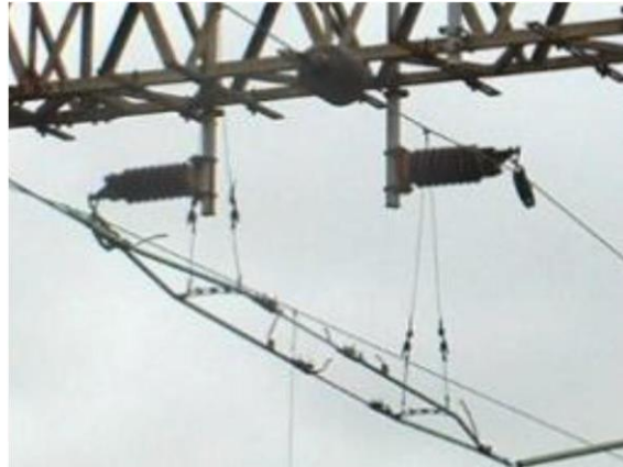
Ilustración 17 Aislador de sección ligero (AV)
