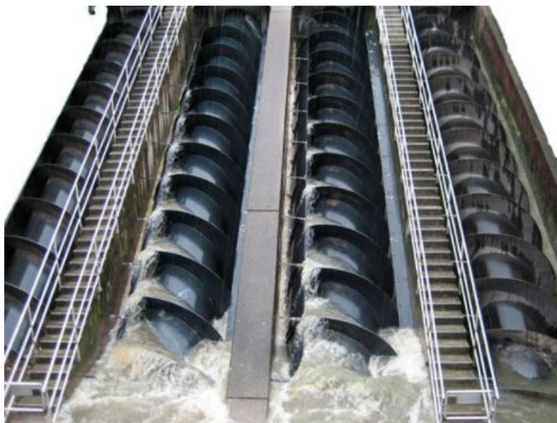
Figura 10. Tornillo de Arquímedes en depuradora
