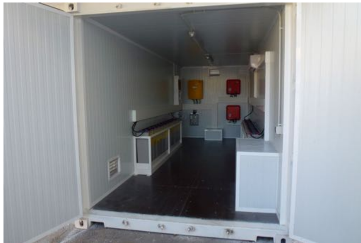
ILUSTRACIÓN 122. INTERIOR PLANTA SOLAR 151
