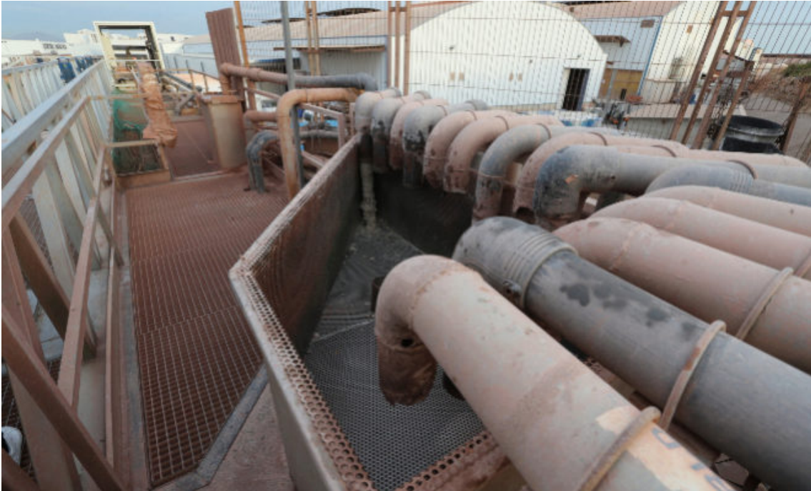
Fig. 30 Instalaciones del Grupo Pamesa para depurar aguas residuales procedentes de 14 fábricas del sector.
