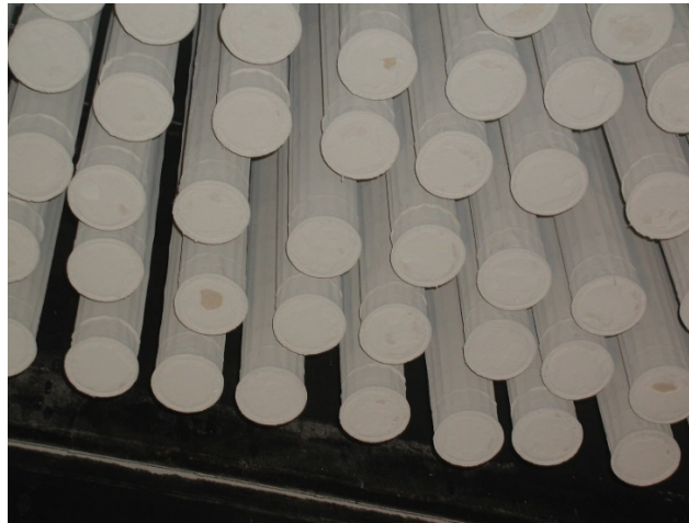
Fig. 27 Filtros de mangas con polvo, debido a su captación.
