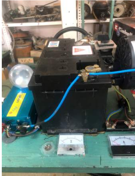
Figura 32: Batería. Fuente: Elaboración propia
