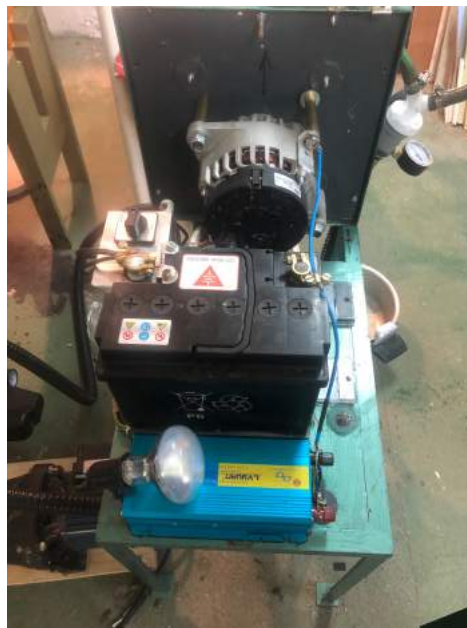
Figura 35: Conjunto alternador, inversor y batería. Fuente: Elaboración propia
