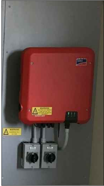
INVERSOR SUNNY BOY 3.0 KW DE SMA (SB 3.0-1AV-41) (INSTALADO EN PLANTA 1)
