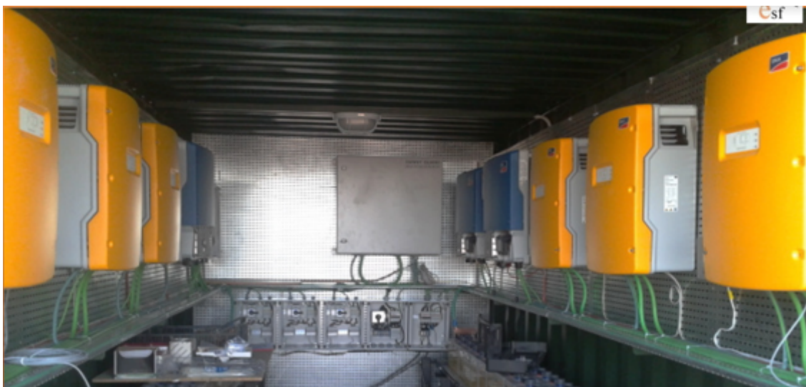
Figura 9: Sunny Tripower y Sunny Island instalados. Fuente: Energía Sin Fronteras
