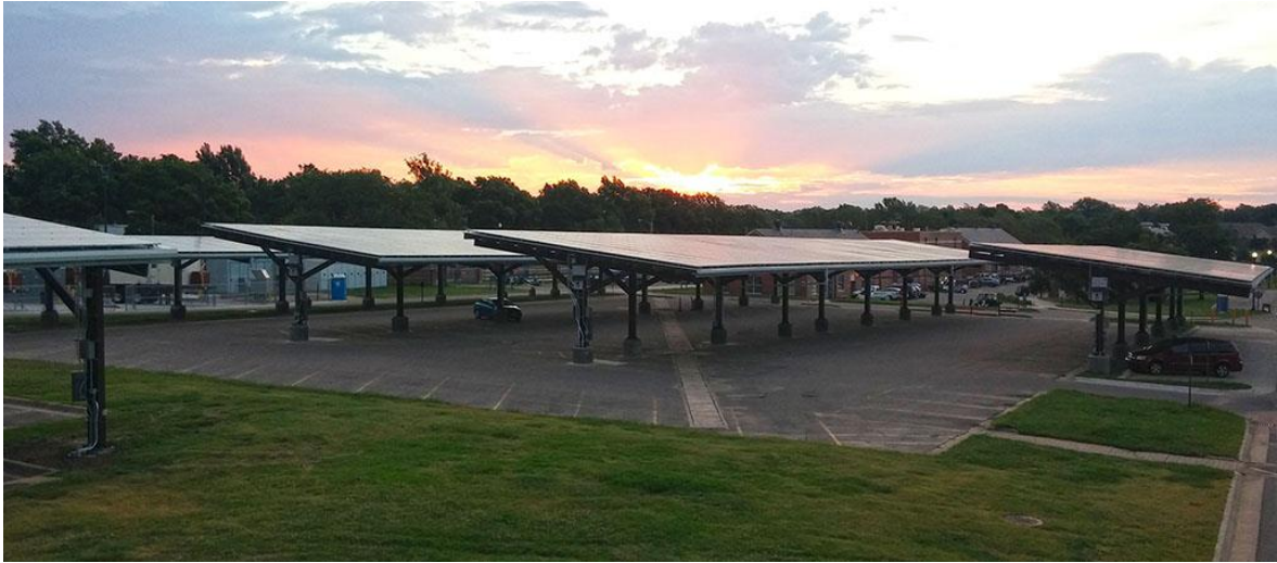
Ilustración 8 Instalación Fotovoltaica en Clemson University de Aparcamiento
