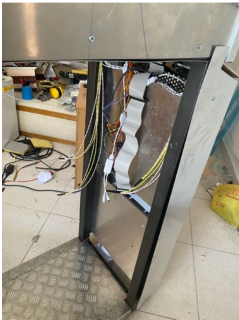
Ilustración 74: Cableado de la electrónica.
