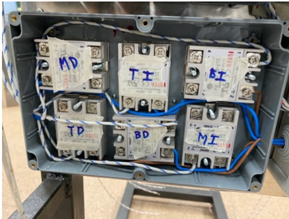
Ilustración 54: Cajetín de relés.
