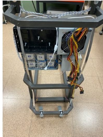
Ilustración 55: Montaje del cajetín de relés.
