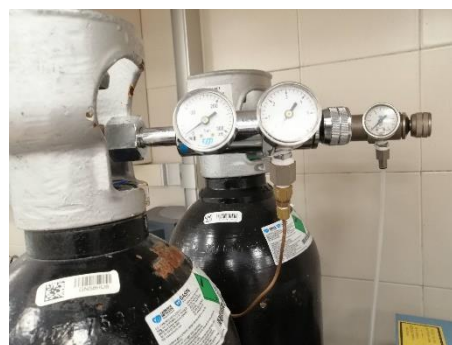
Ilustración 45: Detalle Manómetros de las Balas
