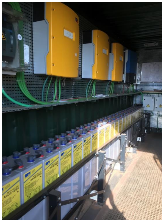
Ilustración 9: Instalación actual de ISF en el huerto solar.
