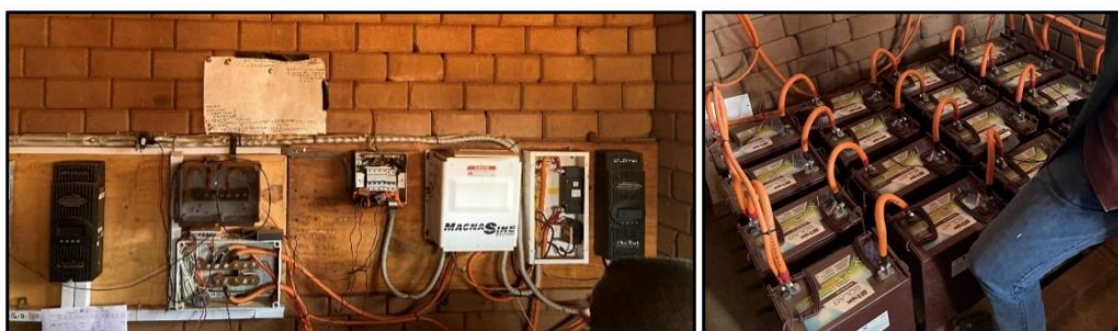
Fotografía 13. High School / Instalación IT. Elaboración Propia
