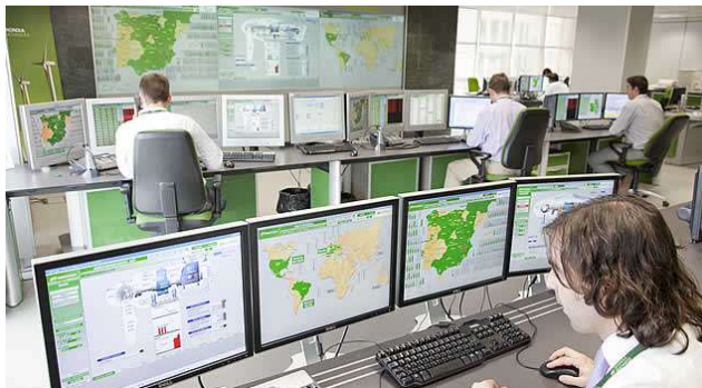
Ilustración 34: Sala de control de un parque eólico
