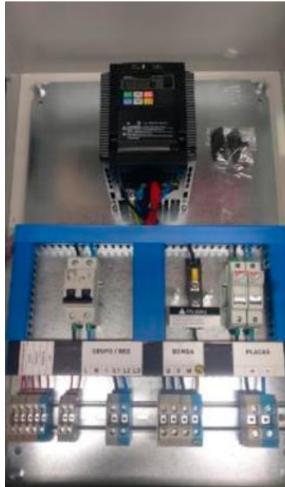
Figura 47: Variador de frecuencia (Fuente: Inversolar, 2023)
