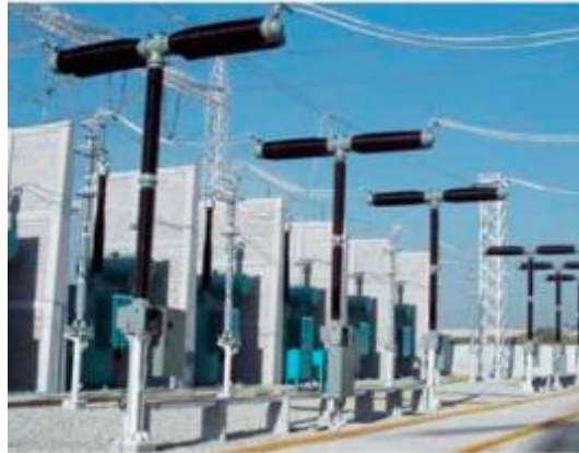
Figura 67: Interruptor Siemens 3AP1
