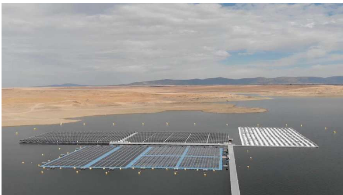
Ilustración 7 Parque fotovoltaico flotante situado en el embalse de Sierra Brava, Cáceres (Acciona, 2020).
